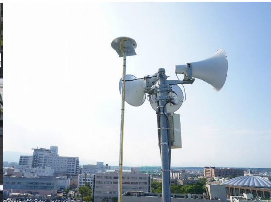
三重大学に設置した GNSS基準局
